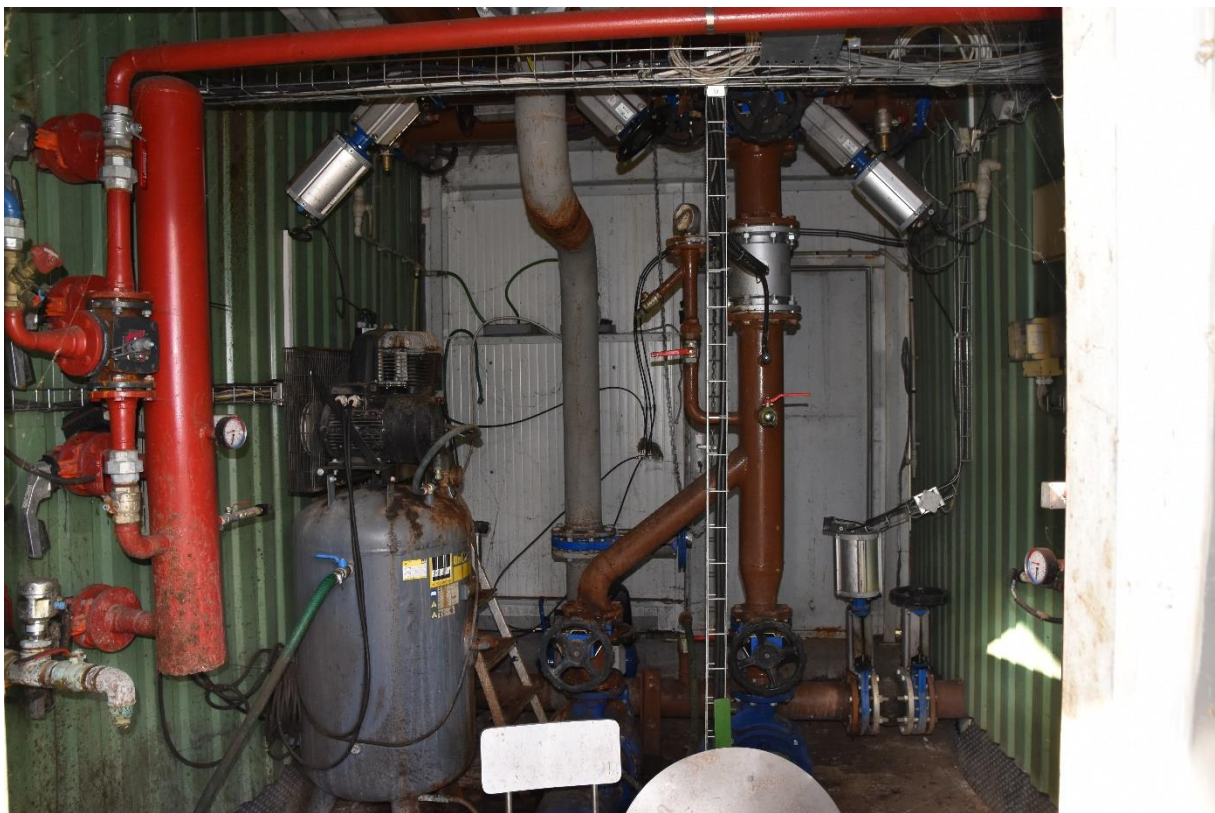
Viditelná koroze jednotlivých dílů potrubí.
