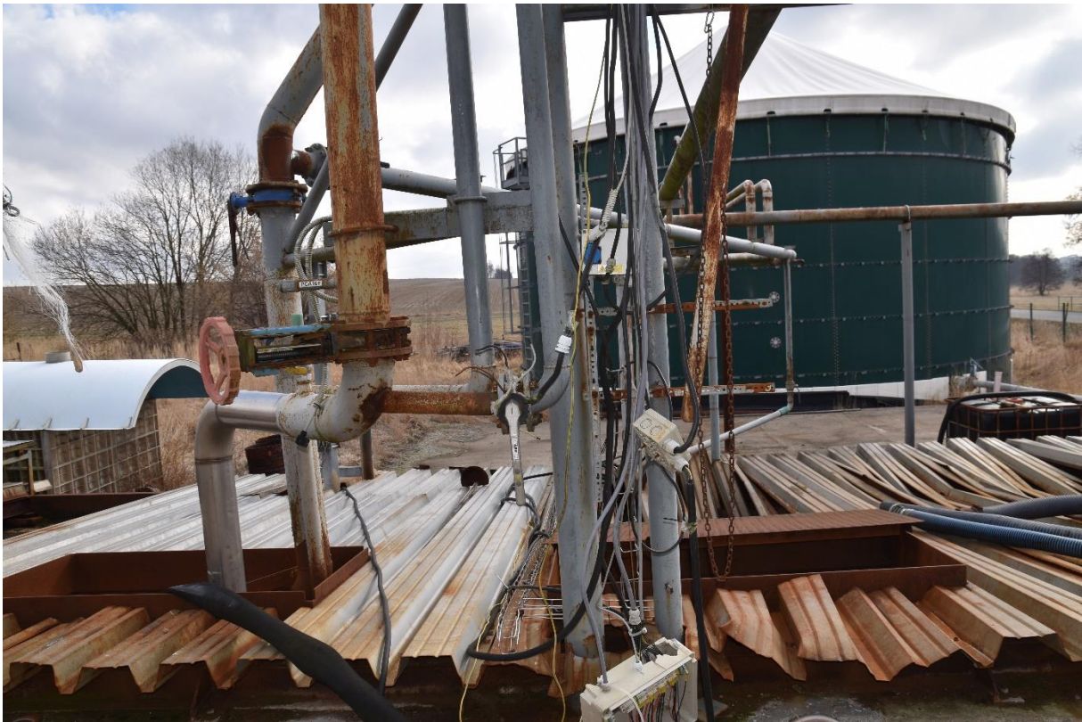
Koroze kovových součástí venkovní části.
