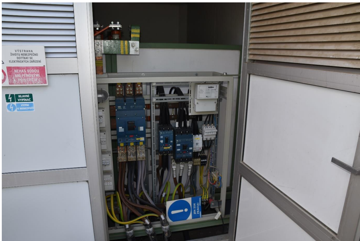
Stav vybavení trafostanice.
