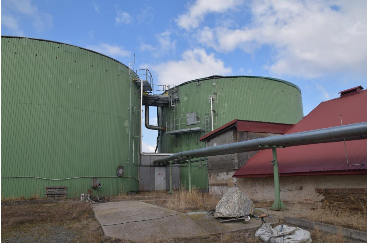
Fermentor I a II. Krycí plachty fermentorů jsou protřžené, nutná výměna.
