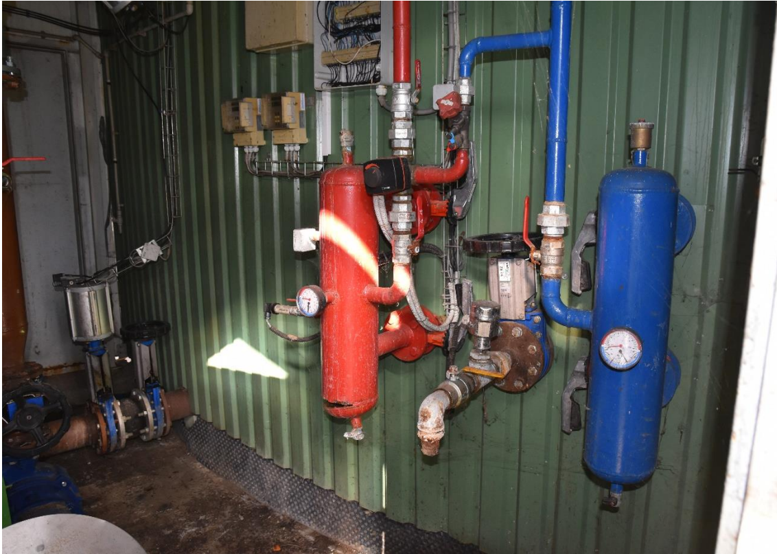
Detail na prasklý přetlak.
